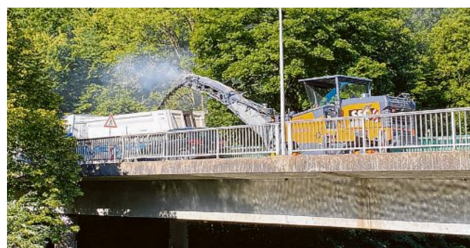
Schweres Gerät ist am Werk auf der Limpurgbrücke, die vor dem Stadtwerkgebäude den Kocher überbrückt. Der Fahrbahnbelag kommt weg. Auch die überstehenden Seiten der Brücke werden entfernt. Foto: Tobias Würth
